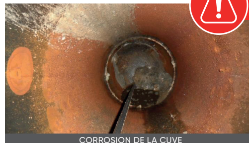
CORROSION DE LA CUVE
