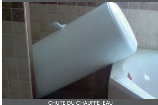
CHUTE DU CHAUFFE-EAU
