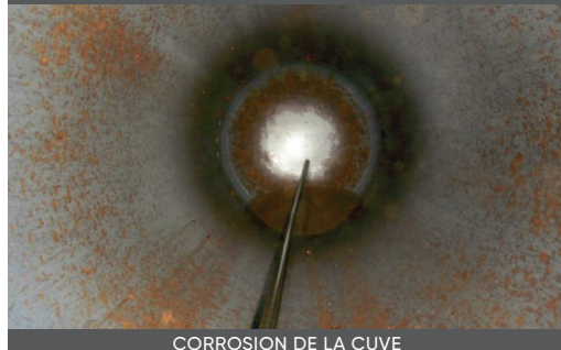
CORROSION DE LA CUVE
