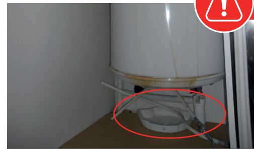
ESPACE INSUFFISANT SOUS LE CHAUFFE-EAU
